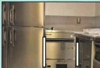
厨房機器の隙間
